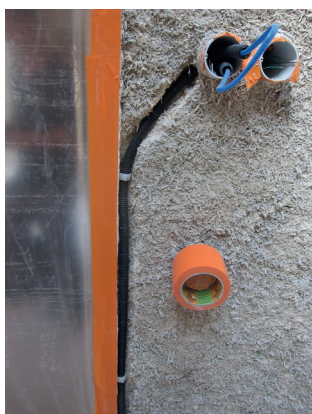
Rainurage pour incorporer une gaine oubliée : à éviter.
