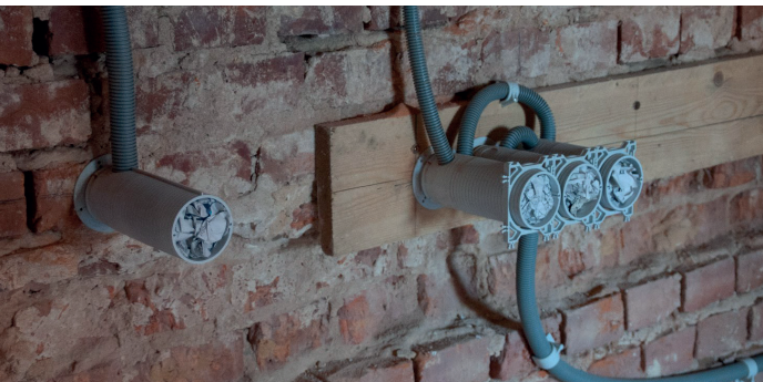
Boîtiers électriques à rallonge fixés en fond de paroi.
