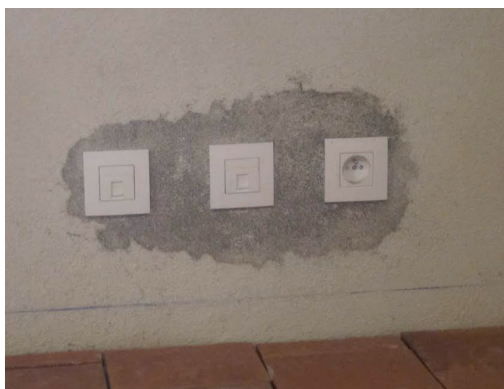
Efflorescences dues à l'utilisation d'un mortier de scellement inadapté.
