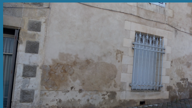
Pathologie due aux remontées capillaires et enduit inadapté.
