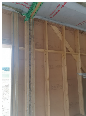
Écharpe de contreventement constituant un masque de projection. Remplissage d'un endroit inaccessible en projection par de la laine de bois.
